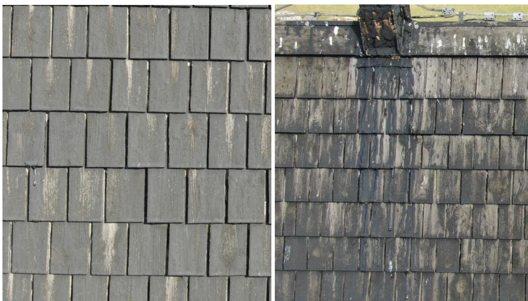
Figur 64 och figur 65: Flertalet spån har ännu kvar ett täckande tjärlager. Bild till höger, närbild på södra takfallets övre delar. Flera spån saknar i dessa partier en heltäckande tjäryta.
