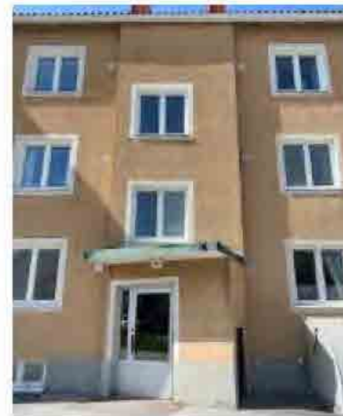
Trapphusen är tidstypiskt markerade genom att de skjuter ut något från fasadlivet.
