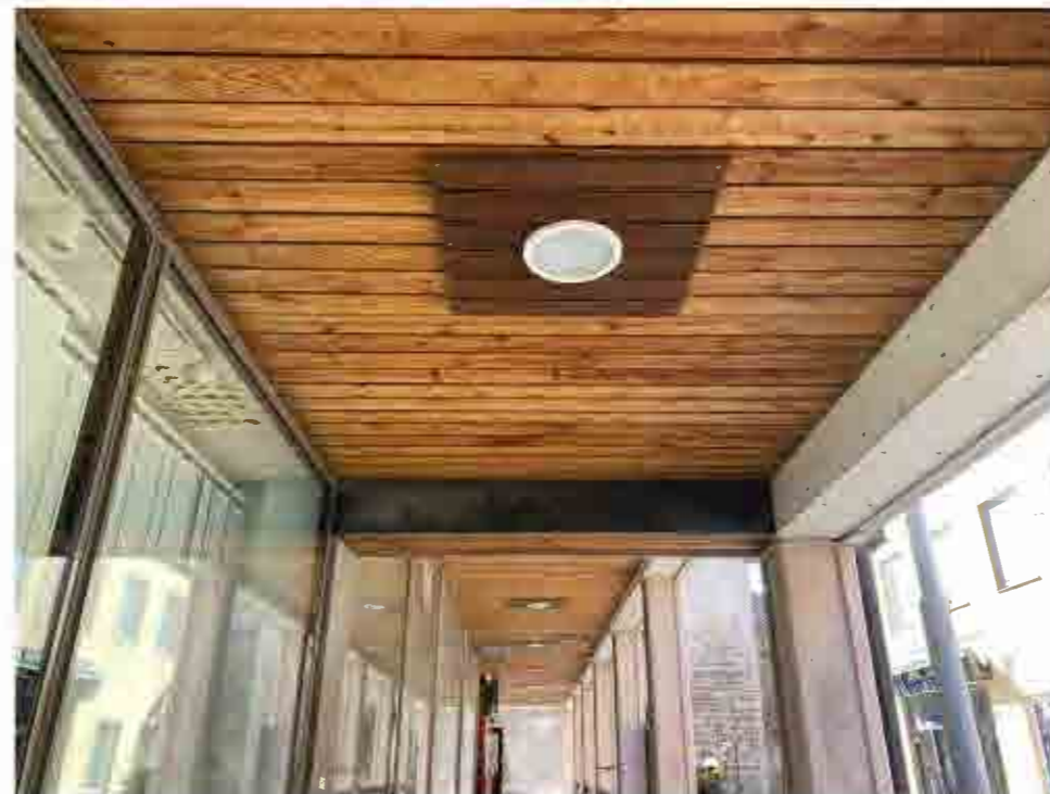
Panelklätt innertak, armaturerna är utbytta.
