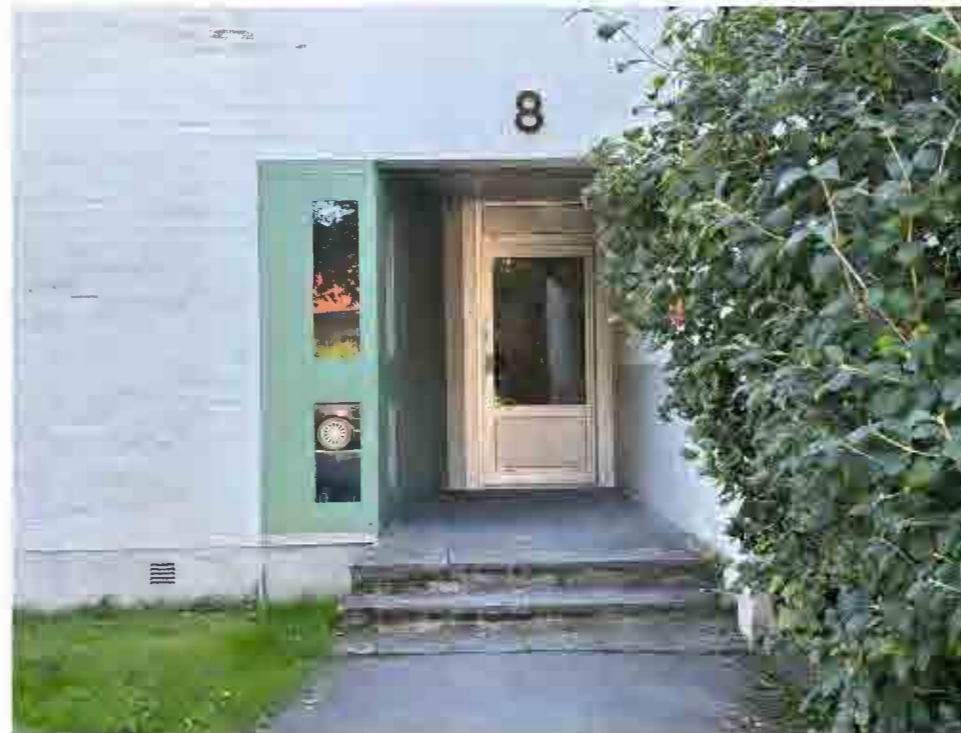
Entréläge med barnvagnsförråd bakom grönmålat parti. Sekundärt utbytt port.
