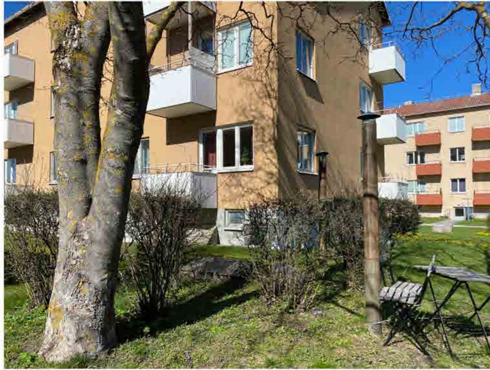
Lufningsrör och uppvuxen växtlighet mellan byggnadskropparna.
