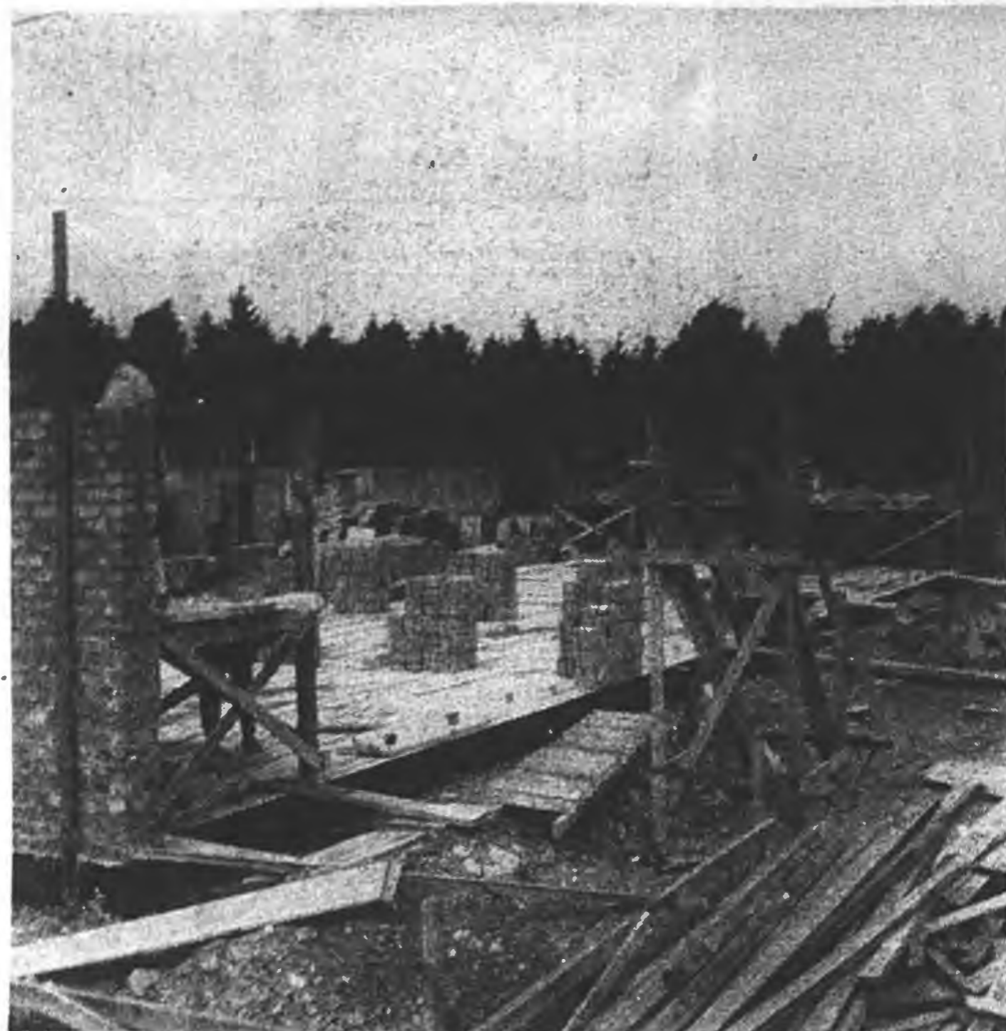
På järnvägens gamla upplagsområde reser sig nu väggarna till ett nytt bostadsområde med 13 lägenheter, poststation m. m. I februari skall det vara klart.
