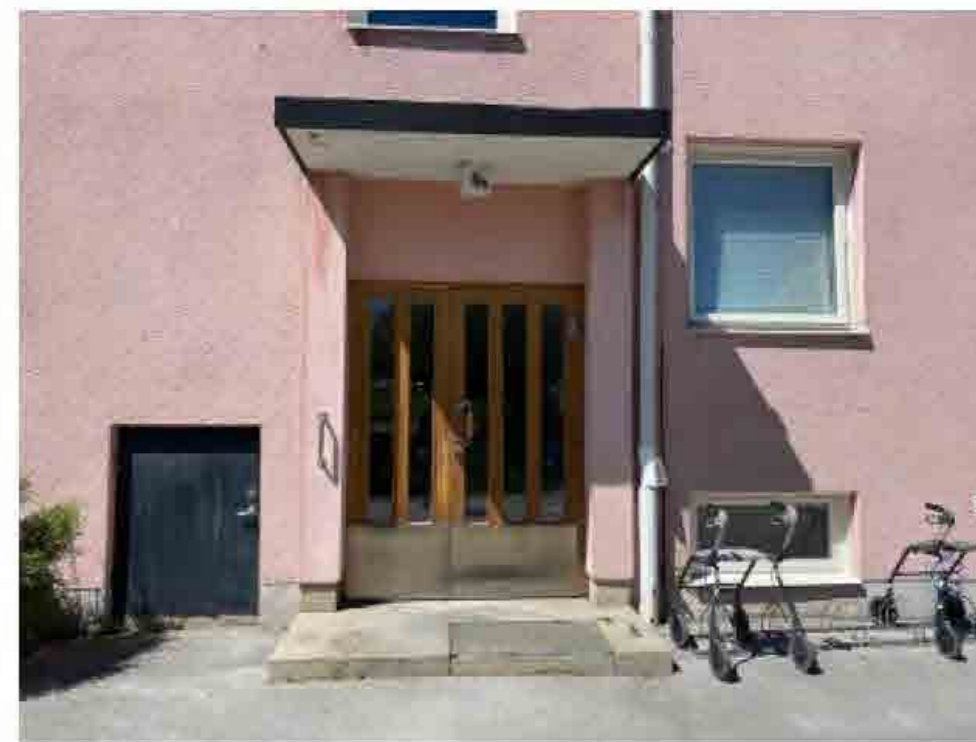
Ursprunglig port med sparkskydd i plåt och nedfällt skrapjärn i trappsteget.
