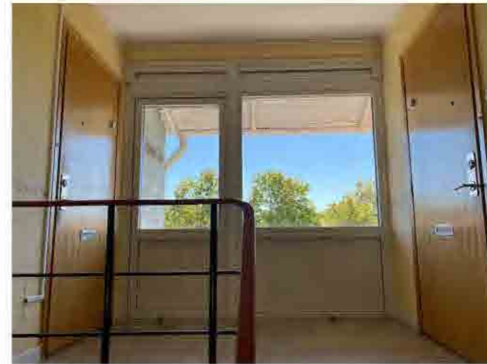
Ett av trapploppens övre våningsplan. Ursprungliga lägenhetsdörrar och smidesräcke med överliggare i röd krympplast.
