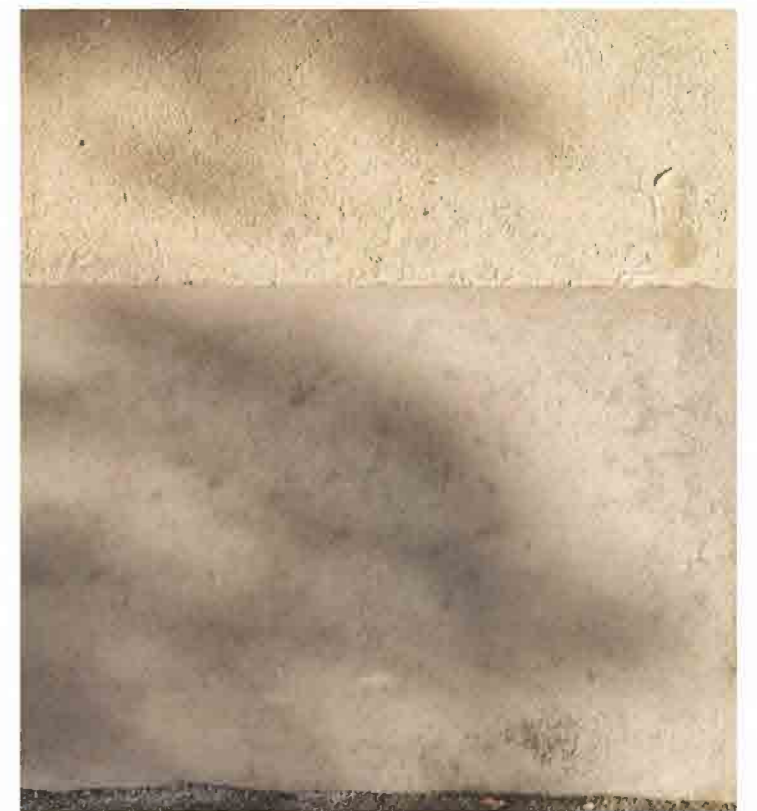
Närbild på ursprungliga putsytor i november 2022, innan renoveringen.
