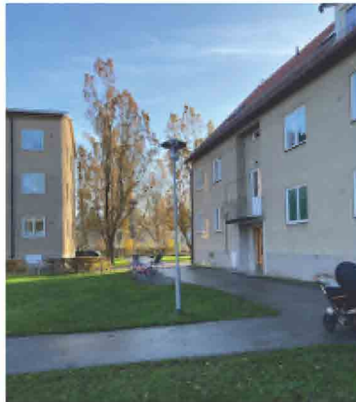
Närbild på ursprungliga putsytor i november 2022, innan renoveringen.
