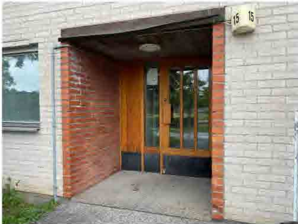
Entrélägena har väggar murade i, mot fasaden i övrigt, kontrasterande rödtegel. Ursprunglig port i trä och glas, med sparkskydd i räfflat gummi.
