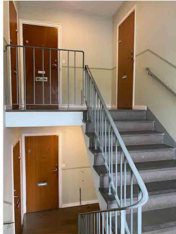
Trapplopp med ursprungliga lägenhetsdörrar, golv och täckmålade smidesräcken med överliggare i krympplast.
