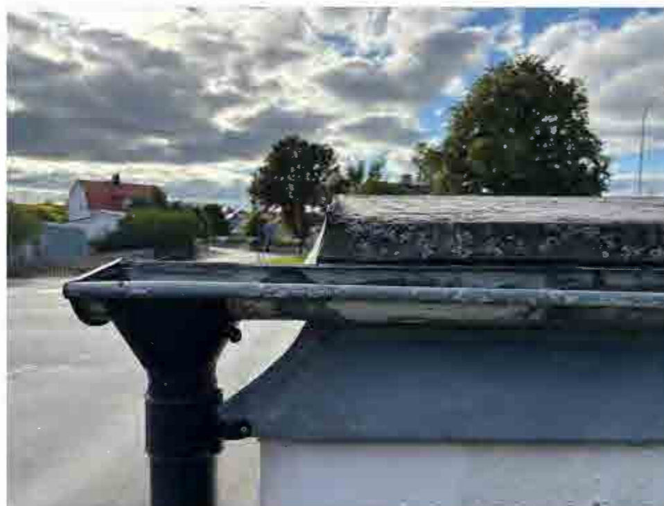
Avvattningslösning hos garagebyggnad.
