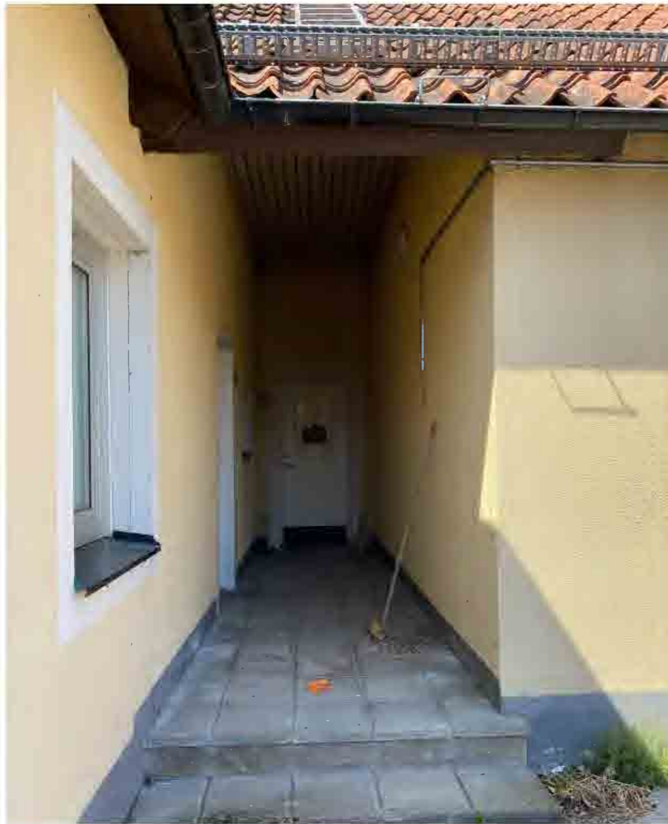
En av entréerna, djupt indragen från fasad i vinkeln mellan två huskroppar. Fasaderna är tilläggsisolerade och på bilden syns också ett av de utbytta fönstren.
